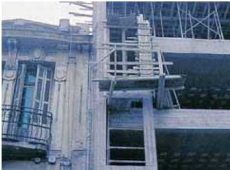
▲ Ασφαλές διπλό λατάκι (τρυπόξυλο) αριστερά. Δάπεδο εργασίας προστατευμένο μερικώς έναντι πτώσης. Ασφαλέστερα τα μαδέρια αντί πλακάς.
