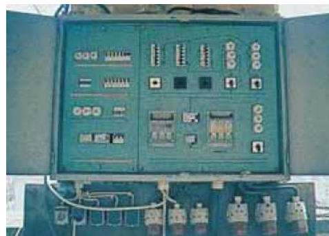
▲ Δεν ξεχνάμε τον αντιηλεκτροπληξιακό διακόπτη (συνδεδεμένο με όλες τις παροχές) και την καθημερινή δοκιμή της καλής λειτουργίας του.
