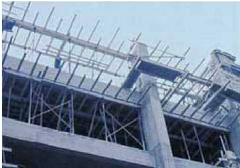
▲ Δάπεδα εργασίας ασφαλή στο σχεδιασμό τους. Απαιτείται: Συμπλήρωση στην προστασία έναντι πτώσης. Αντικατάσταση των πλακάς με μαδέρια.
