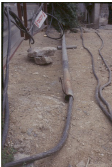
▲ Προστασία καλωδίων από μηχανική φθορά
