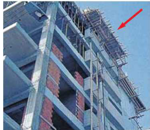
▲ Σκαλωσιές εξωτερικών τοιχείων χωρίς προστασία έναντι πτώσης.
