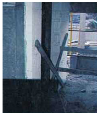
▲ Απαράδεκτη προστασία ανοίγματος ανελκυστήρα.
