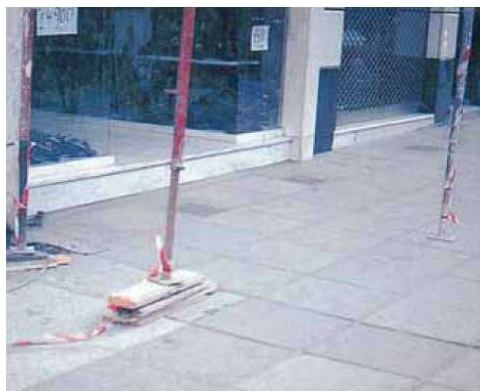
▲ Απαράδεκτη έδραση σκαλωσιάς (δύο ορθοστάτες αριστερά). Ορθή έδραση (ορθοστάτης δεξιά).
