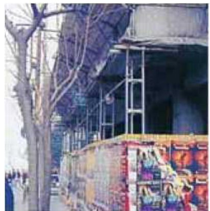
▲ Περίφραξη εργοταξίου με άδεια κατάληψης πεζοδρομίου. Προστατευτικό προστέγασμα. Απαιτείται συμπλήρωσή του στο γωνιακό τμήμα.
