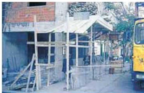
▲ Προστατευτικό προστέγασμα με ακατάλληλη - επικίνδυνη κλίση.
