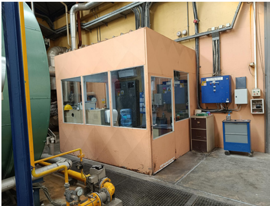
Εικόνα 6: Κλιματιζόμενος χώρος στο λεβητοστάσιο για την αποτροπή θερμικής καταπόνησης του θερμοστή.
