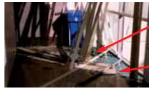
Θραύση τζαμιών υαλοστασίων
