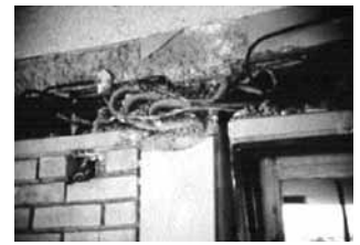
Ζημιά σε υποστυλώμα λόγω του φαινομένου κοντού υποστυλώματος
